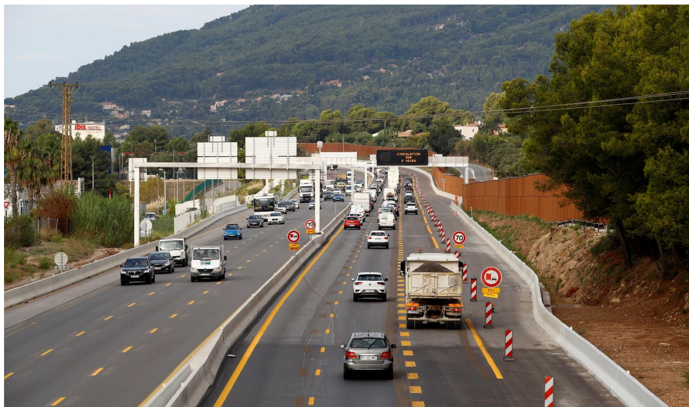
A57 – Mise en circulation anticipée de la 3 e voie dans le secteur de Pierre-Ronde © Alain Tendero – 24 septembre 2024
