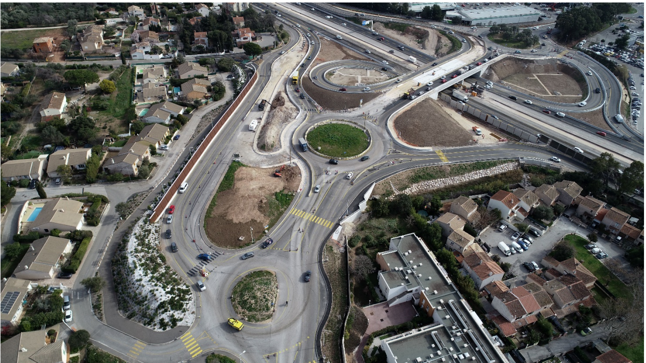
Élargissement A57 - Échangeur de La Valette Nord (secteur de La Bigue) - Photo Elite Drone - Février 2024
