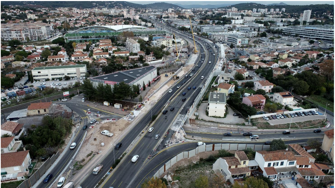
Élargissement A57 dans les secteurs de La Palasse et de Sainte-Musse : Photo Elite Drone
